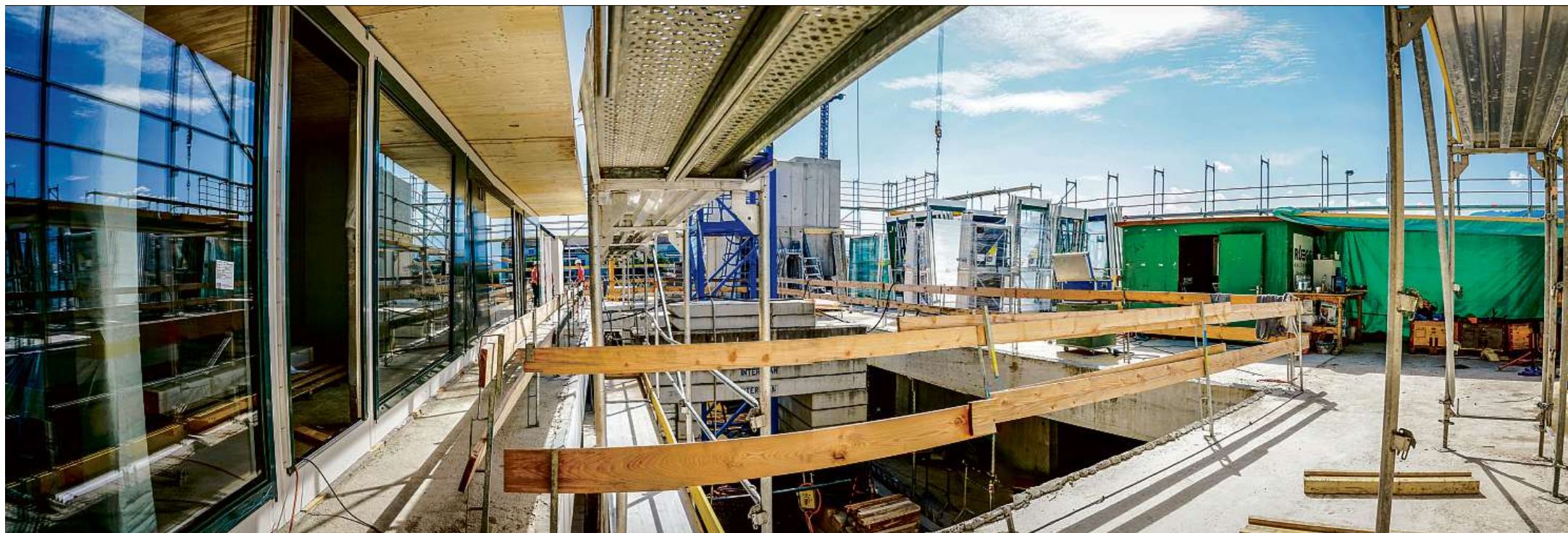
Bau nimmt langsam Form an: Nächsten Sommer soll das Studentenwohnheim zur Benutzung übergeben werden können.
