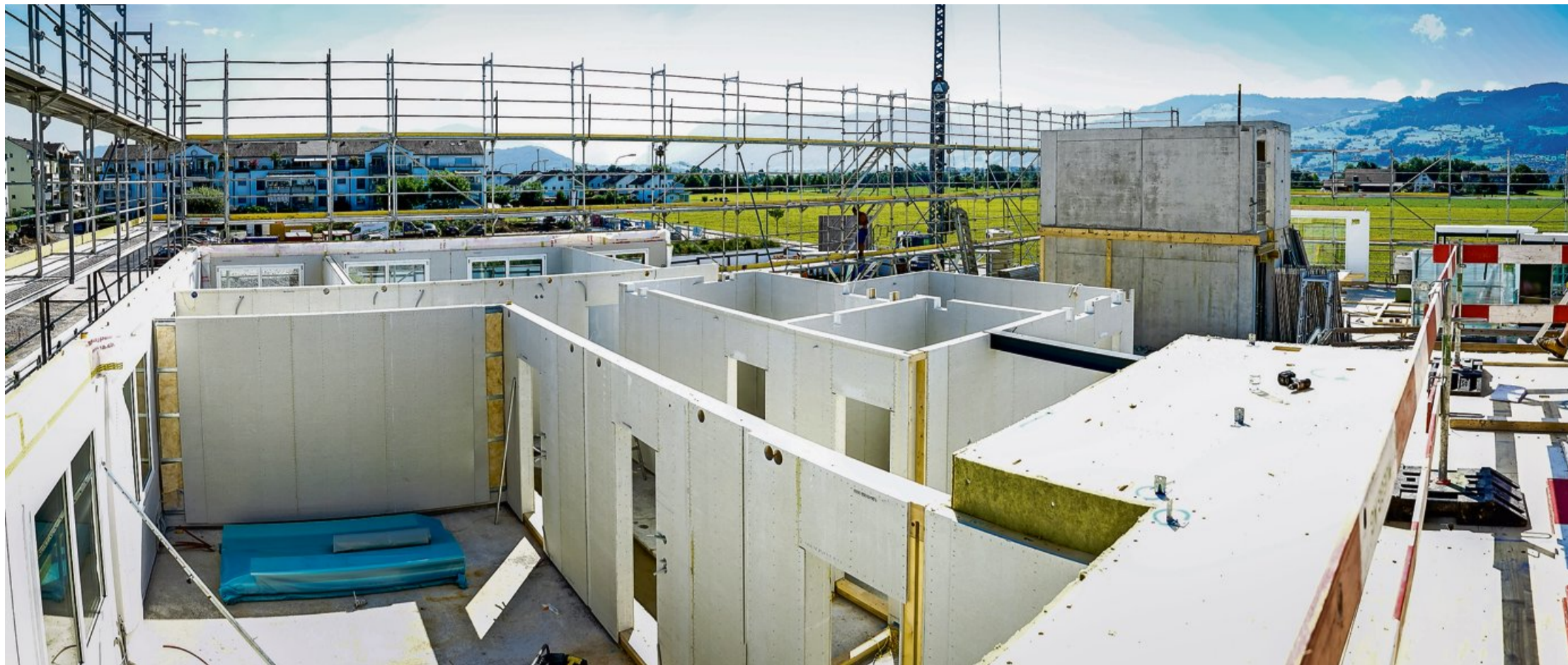
Hier entsteht ein Campus: Die beiden oberen Geschosse des neuen Studentenwohnheims an der Obergasse 97 werden in den nächsten Tagen mit Holz verkleidet.
